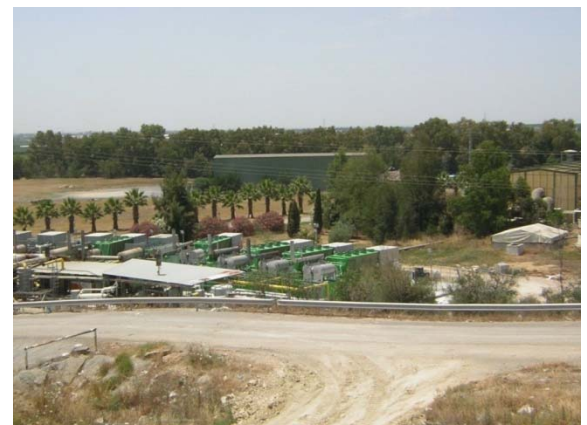
Foto 8: Planta de Biogás. Motogeneradores
