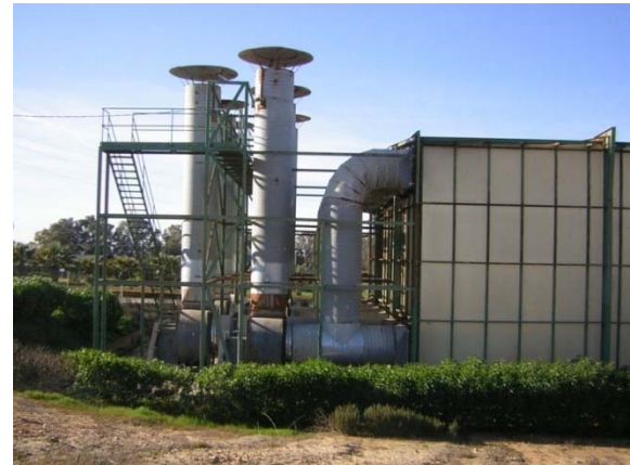
Foto 7: Tratamiento de Lixiviados (Evaporación y Cogeneración)
