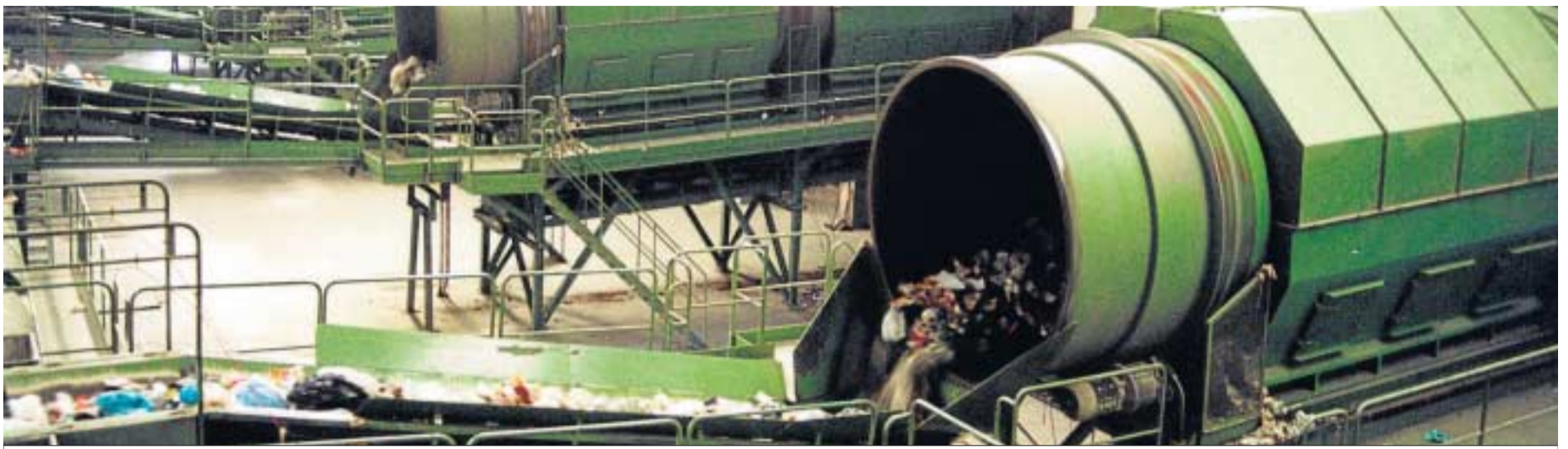
Instalaciones de Montemarta-Conica, el complejo que gestiona Aborgase
