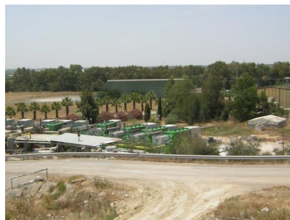
Foto 8: Planta de Biogás. Motogeneradores
