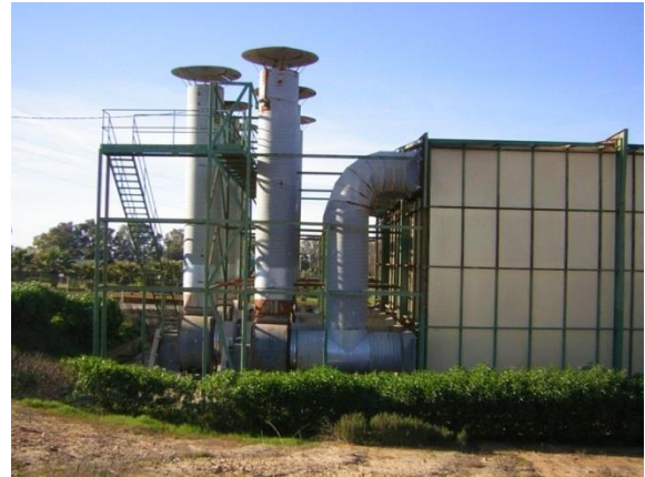
Foto 7: Tratamiento de Lixiviados (Evaporación y Cogeneración)
