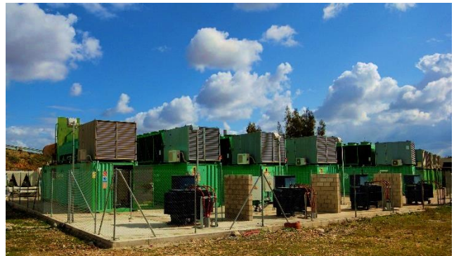
Foto 8: Planta de Biogás. Motogeneradores
