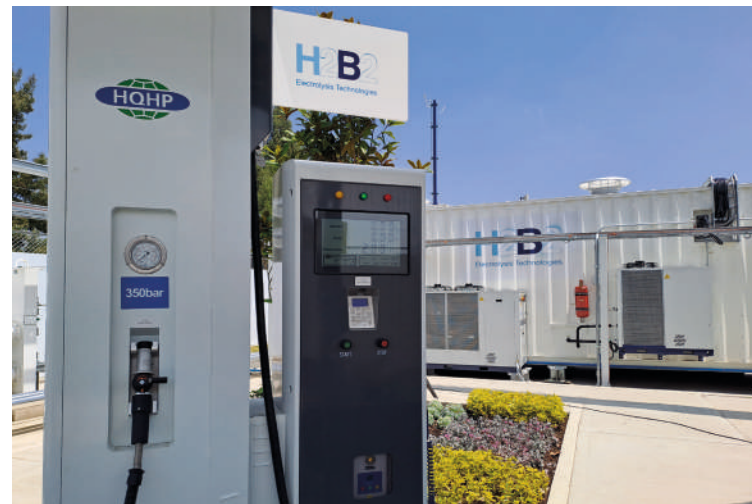
HRS Colombia. Estación de servicio de hidrógeno, para la empresa Ecopetrol, en Bogotá (Colombia). Estación de servicio integrando un electrolizador EL10N, capaz de producir 1 kg/h de hidrógeno y abastecer vehículos pesados (autobuses urbanos) a 350 bar de presión.
